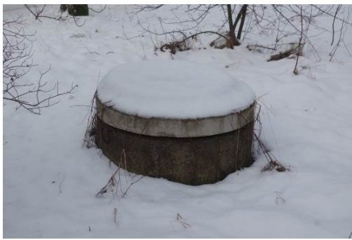
Zemes gabals ar kadastra apzīmējumu 6409 002 0141, kanalizācijas kontrolaka
