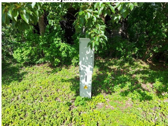
Pieslēguma vieta elektrībai
