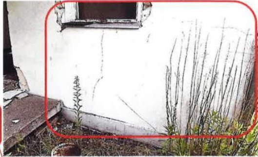
10.attēls. Fasādei saplaisājusi apmetuma padare
