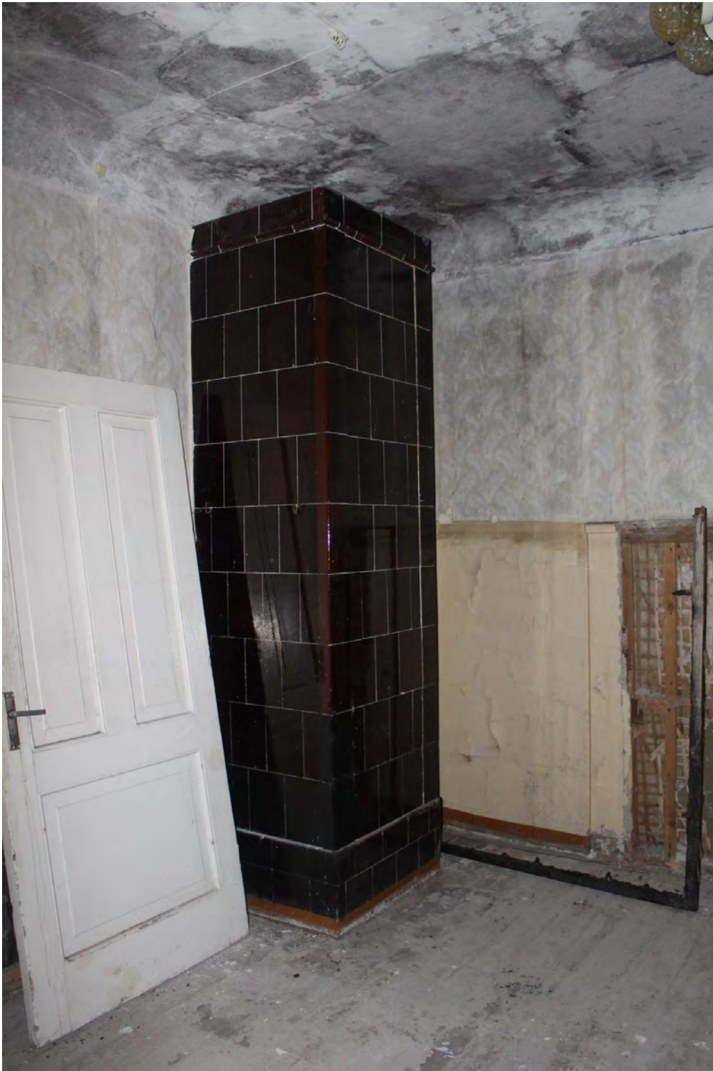
51.att. Podiņu krāsns 2. stāvā.
