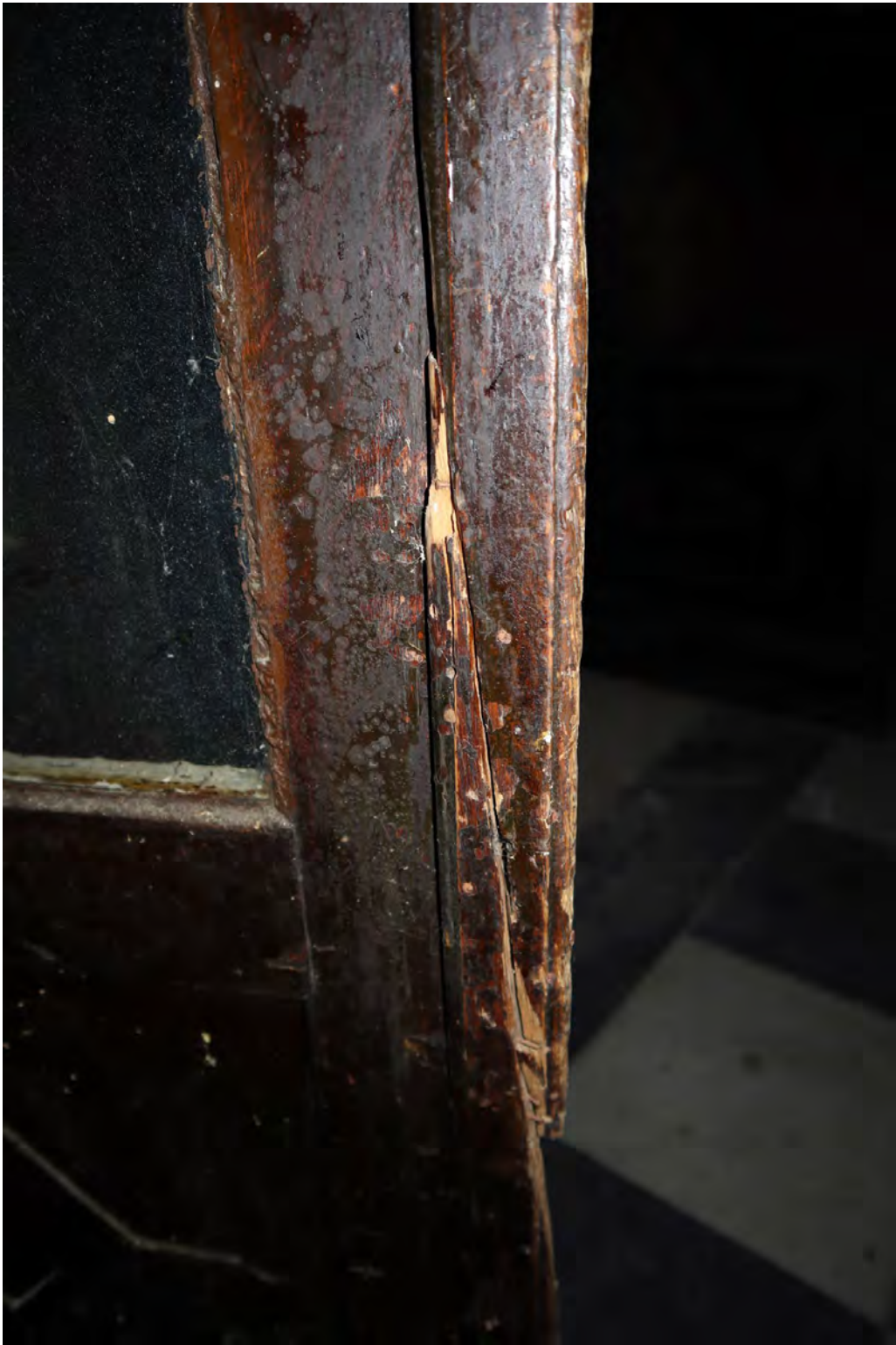
78.att. Vējtvera iekšdurvju bojājums ar koka plaisājumu.
