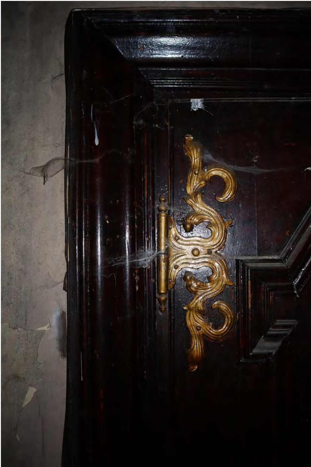
12.att. Sākotnējās iekšdurvis ar profilētu noseglīsti un viru ar metāla apkalumu 1. stāva telpās.
