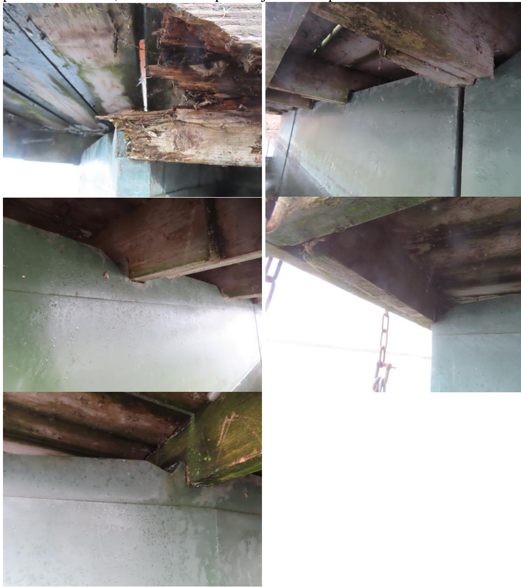
Platforma 2. Sapuvuši balstīšanas koka elementi. Pamatnes balstīšanas mezgls.
