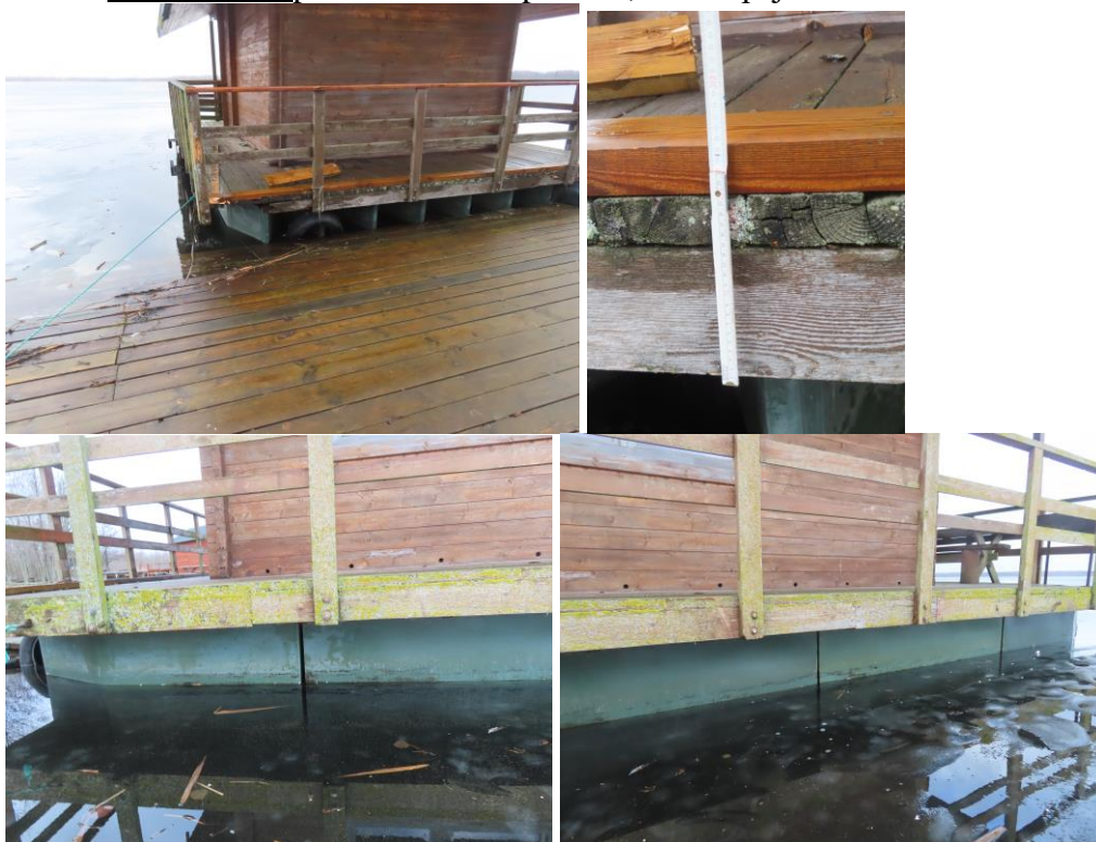
Platforma 2 – PVC pontoni, pamatnes koka elementi sapuvuši.
