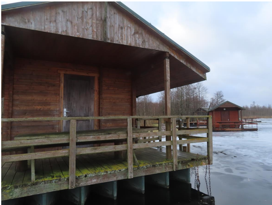
Kempinga mājiņa 2 – novecojuši koka margas elementi un neapstrādāta, daļējie sapuvusi grīda. Jāatjauno fasādes krāsojums.
