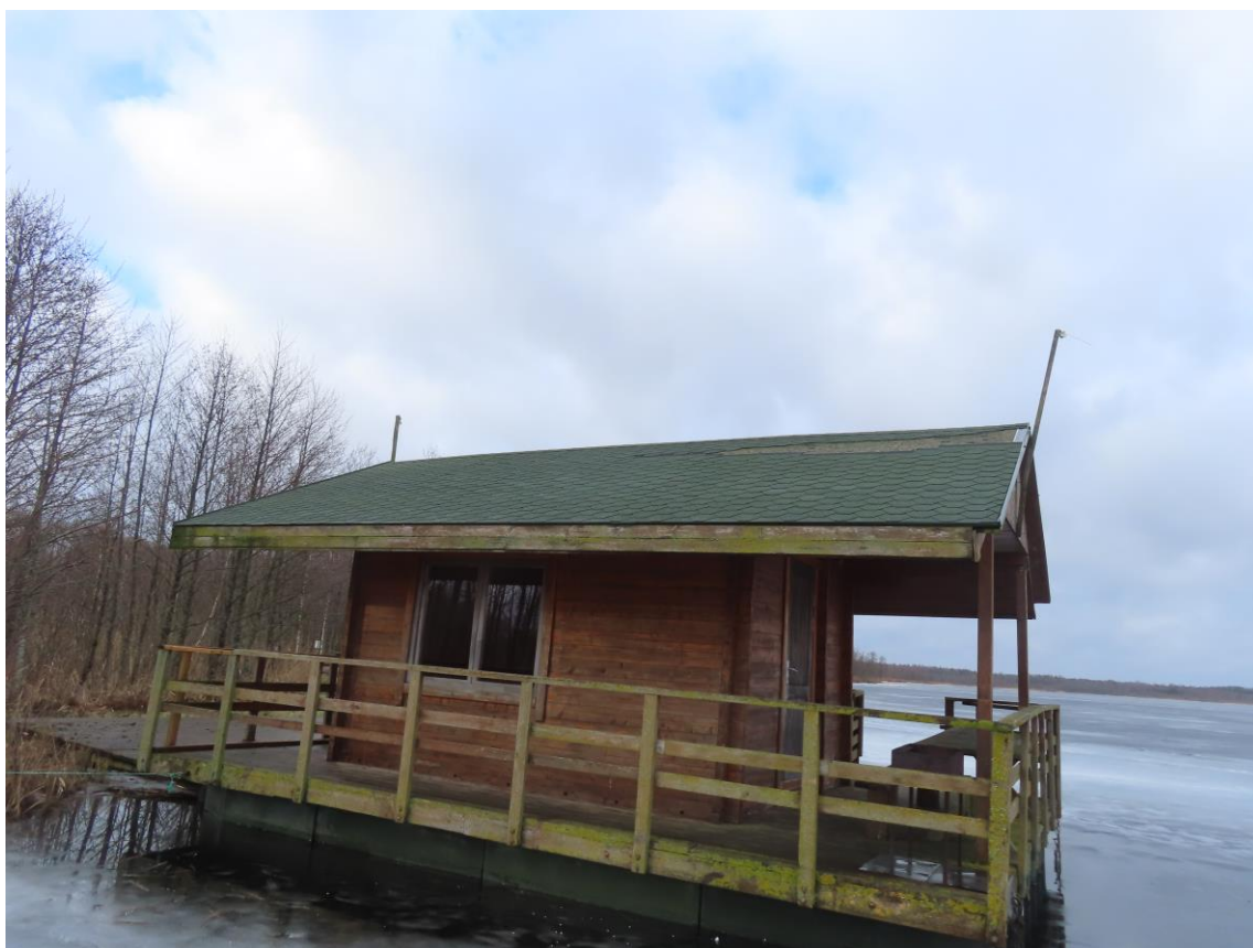
Kempinga mājiņa 2 – novecojuši koka margas elementi un neapstrādāta, daļējie sapuvusi grīda. Jāatjauno fasādes krāsojums. Jumta seguma lokāls bojājums
