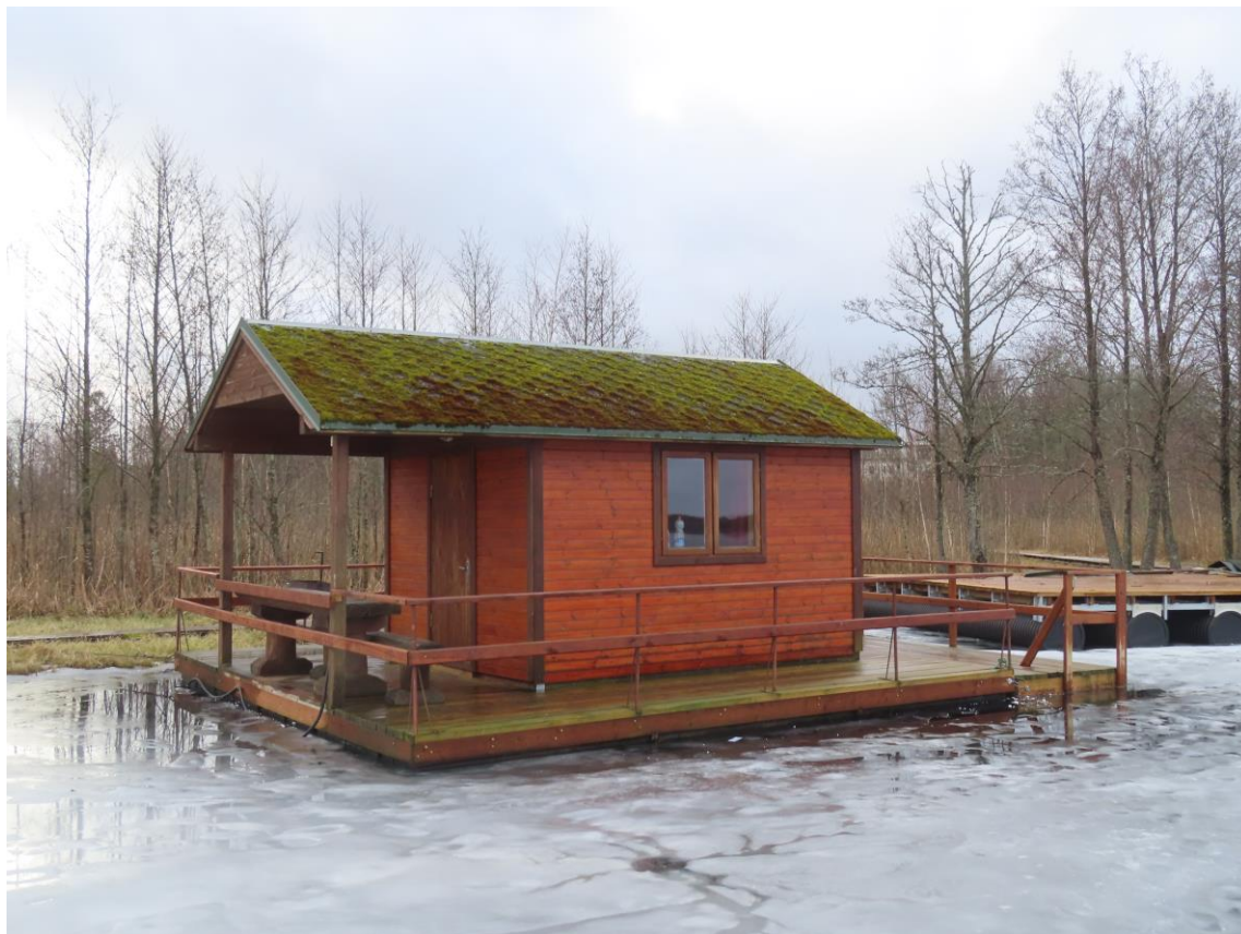
Kempinga mājiņa 1 - jumts apaudzis ar sūnām. Elektrības pieslēgumi pie margām. Fasādes krāsojums, grīda platformai un pamatne ir atjaunota.
