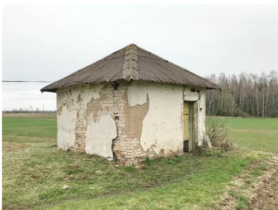
Sūkņu stacijas ārskats
