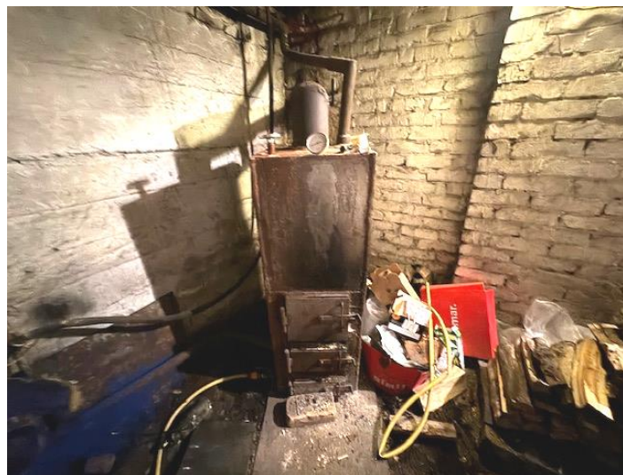
Skats uz apkures katlu
