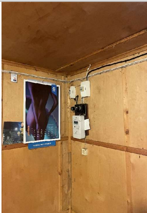
5.7.1 att. Elektrības pieslēguma vieta
