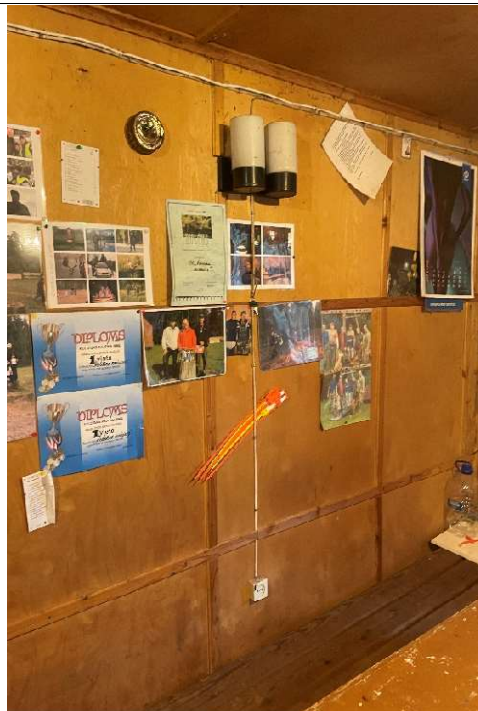
5.7.2 att. Virs apmetuma elektroinstalācija
