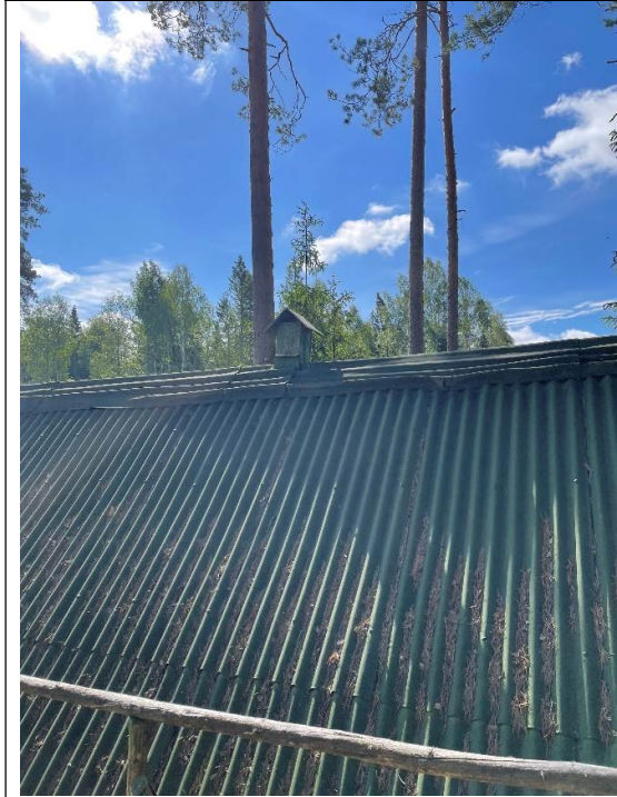
4.14.1 att. Ventilācijas izvads
