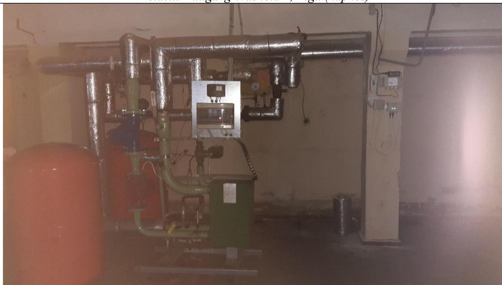
27.att.: Daugavgrīvas iela 2, Rīga (siltummezgls)
