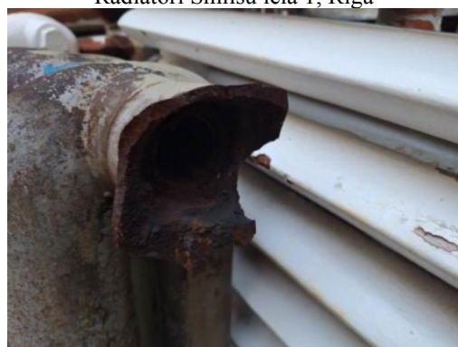
Radiatoru Smilšu ielā 1, Rīgā
