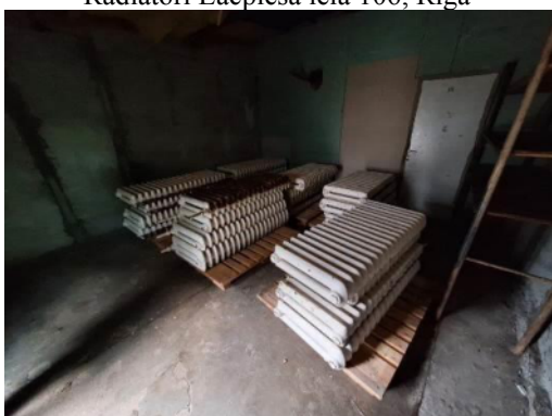
Radiatori Lāčplēša ielā 106, Rīgā
