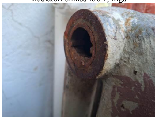
Radiatoru Smilšu ielā 1, Rīgā
