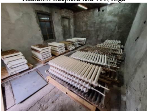
Radiatori Lāčplēša ielā 106, Rīgā
