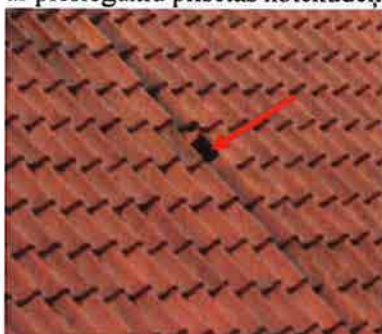
63. att. Iztrūkst seguma elements
