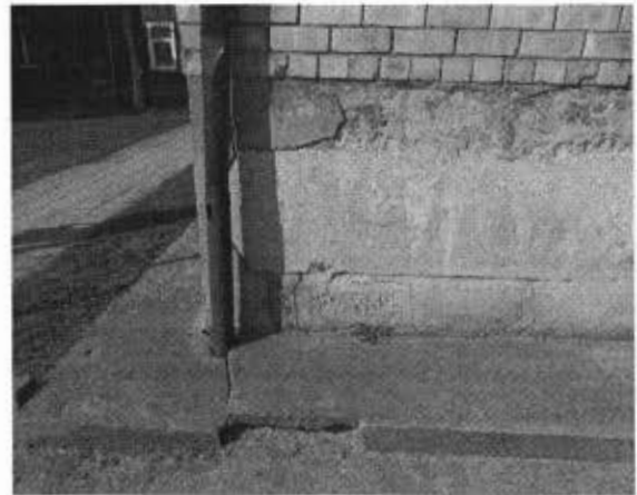
Bojāta ēkas betona aizsragapmale
