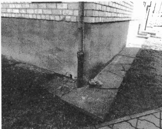
Bojāta ēkas betona aizsragapmale
