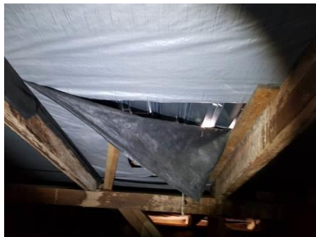
4.8.2.5. att. Jumta seguma izbūves nepilnības
