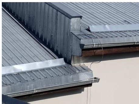
4.8.2.7. att. Jumta seguma izbūves nepilnības
