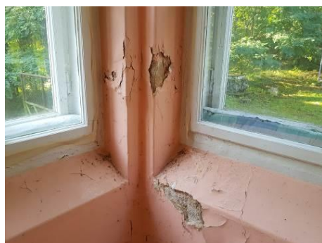
4.18.1.3. att. Kapilārā mitruma radīti bojājumi
