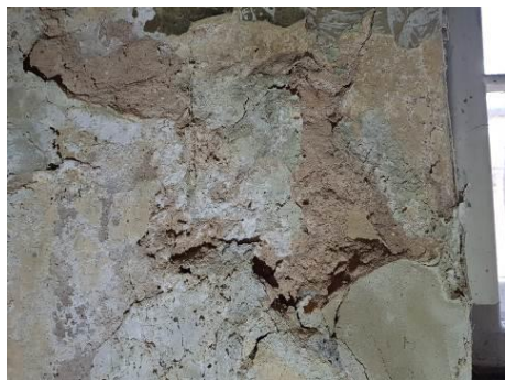
4.5.1.3. att. Kapilārā mitruma radīti bojājumi
