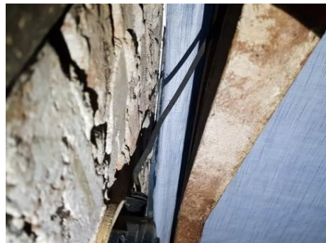
4.8.2.6. att. Jumta seguma izbūves nepilnības
