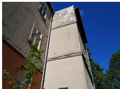
4.8.2.8. att. Jumta seguma izbūves nepilnības
