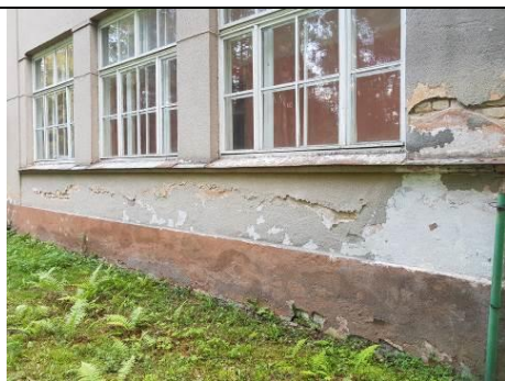
4.5.1.1. att. Kapilārā mitruma radīti bojājumi
