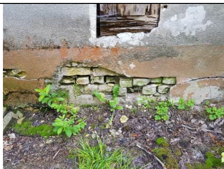
4.2.3.3. att. Bojāta mūra struktūra, mūrjavas erozija
