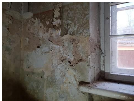
4.5.1.2. att. Kapilārā mitruma radīti bojājumi
