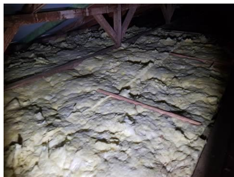
4.5.2.2. att. Bēniņu pārseguma minerālvate
