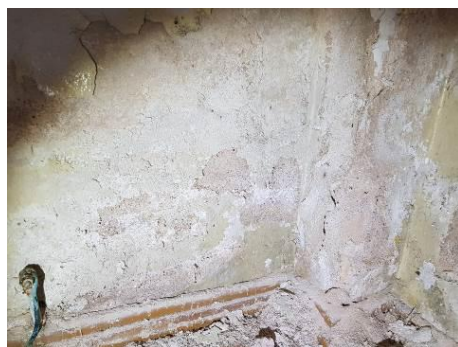
4.18.1.1. att. Kapilārā mitruma radīti bojājumi
