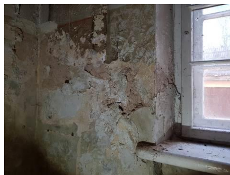
4.18.1.2. att. Kapilārā mitruma radīti bojājumi
