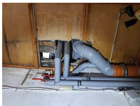
4.5.1.6. att. Inženiertīklu šķērsojums ugunsdrošajā konstrukcijā, nav veikta šķērsojumu aizdare
