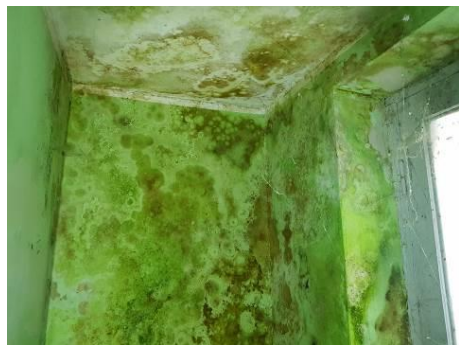
4.5.1.4. att. Mitruma caursūkšanās rezultātā radīti iekšējās apdares bojājumi
