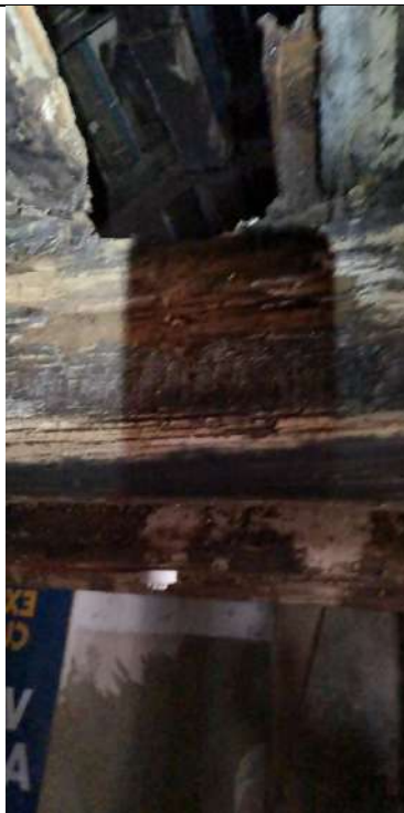
11.d. attēls. Bojāta bēniņu sija, trūks dēļu klājs. (4.stāva pārsegums)
