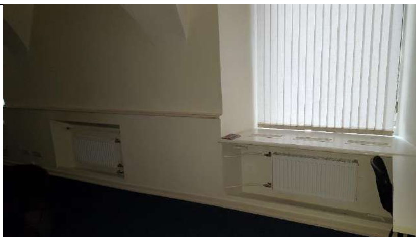
50.attēls. Tērauda radiatori 1.stāvā
