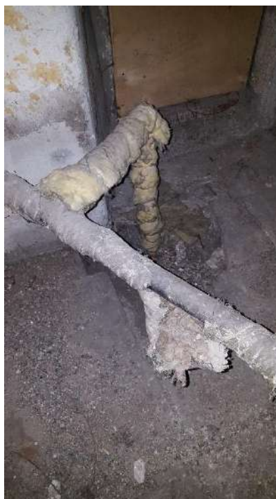
52.attēls. Cauruļvadu siltumizolācija bēniņos ir sliktā stāvoklī.
