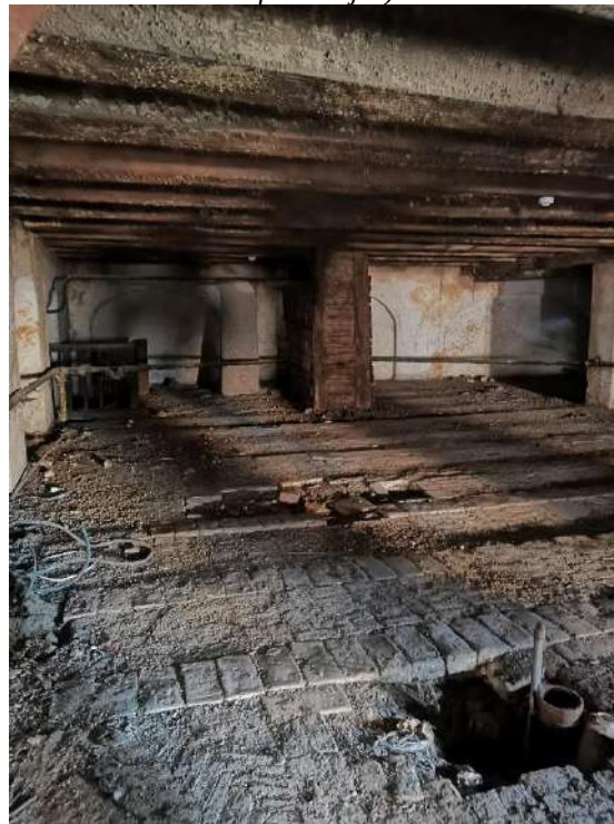
11.b. attēls. ķieģeļu mūra virssegums (redzamas deformācijas).
