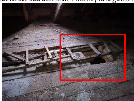
11.e.1.attēls. Bojāta dēļu grīda (caurums)
