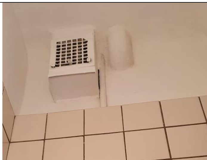
5.6.1.1.attēls. Dabiskās nosūces reste WC telpā
