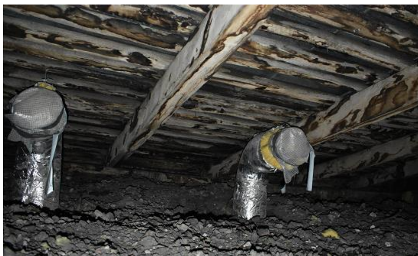
5.6.1.7.attēls. Ventilācijas izvadi bēniņos no 6.stāva telpas
