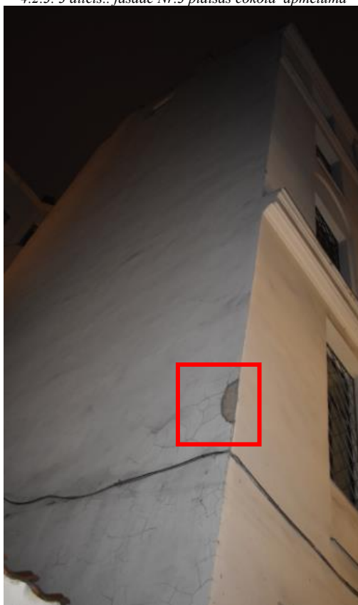
4.2.3. 4. attēls.. fasāde Nr.4 plaisas apmetumā, atslāņojies dekoratīvā apmetuma slānis
