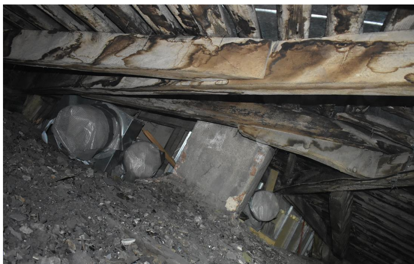
5.6.1.6.attēls. Ventilācijas izvadi bēniņos no 6.stāva telpas
