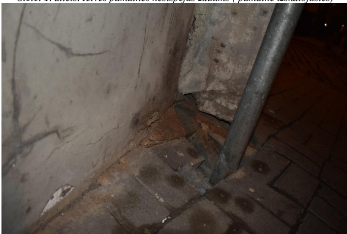
3.1.1. 2. attēls. Ietves pamatnes nestspējas zudums (pamatne izskalojusies)
