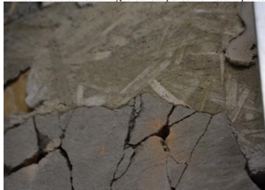
4.2.5. 3. attēls. Plaisas apmetumā 4.2.5. 2. attēlā norādītās betonētas pārsedzes balsta vietā.
