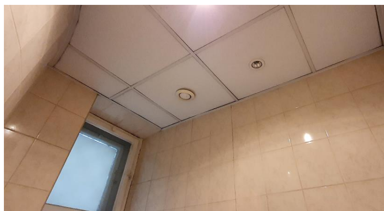
5.6.1.2.attēls. Mehāniskā nosūce WC telpā
