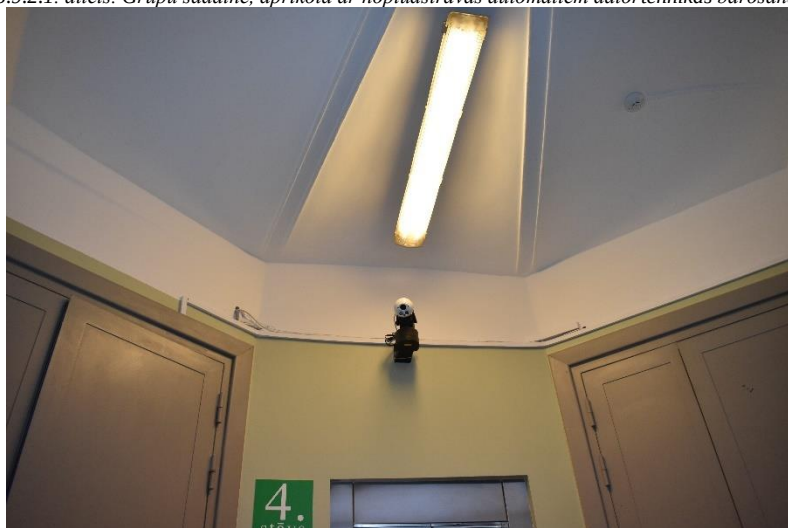
5.9.2.1. attēls. Gaismekļa piemērs kāpņu telpā.
