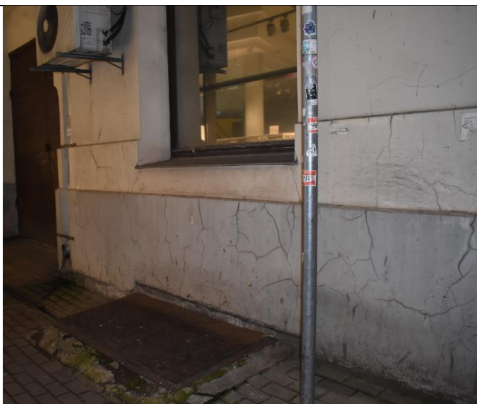
4.2.3. 3 attēls.. fasāde Nr.3 plaisas cokola apmetumā
