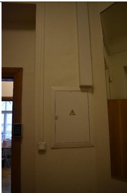
5.1.2.1. attēls. Stāva grupu sadalne, kabeļi montēti kabeļu kanālā.
