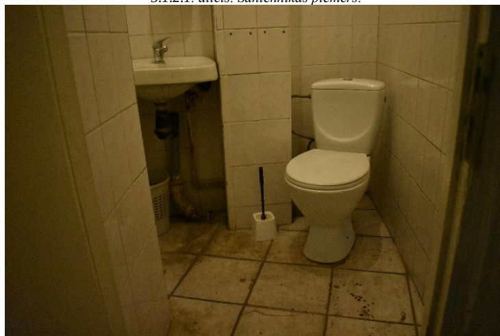
5.1.2.1. attēls. Santehnikas piemērs.
