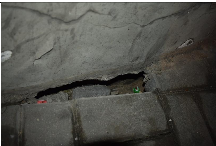
3.1.1. 1. attēls. Ietves pamatnes nestspējas zudums (pamatne izskalojusies)
