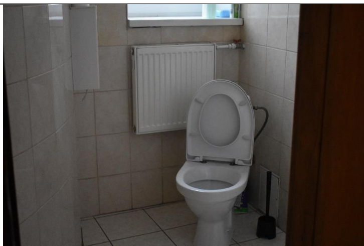
5.1.2.1. attēls. Santehnikas piemērs.
