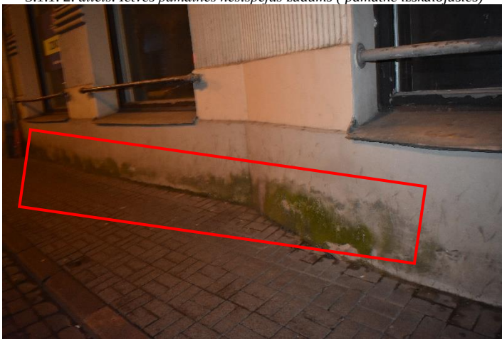
3.1.1. 3. attēls. Gājēju ietve. Virspamatu līmenī redzamas vietas, kas pārklātas ar aļģēm (tas liecina par paaugstinātu mitruma un PH līmeni konstrukcijā).
