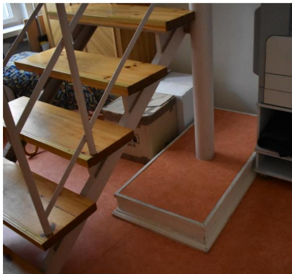
4.10.1. 4. attēls. Metāla kāpnes starp 3. un 4. stāvu
