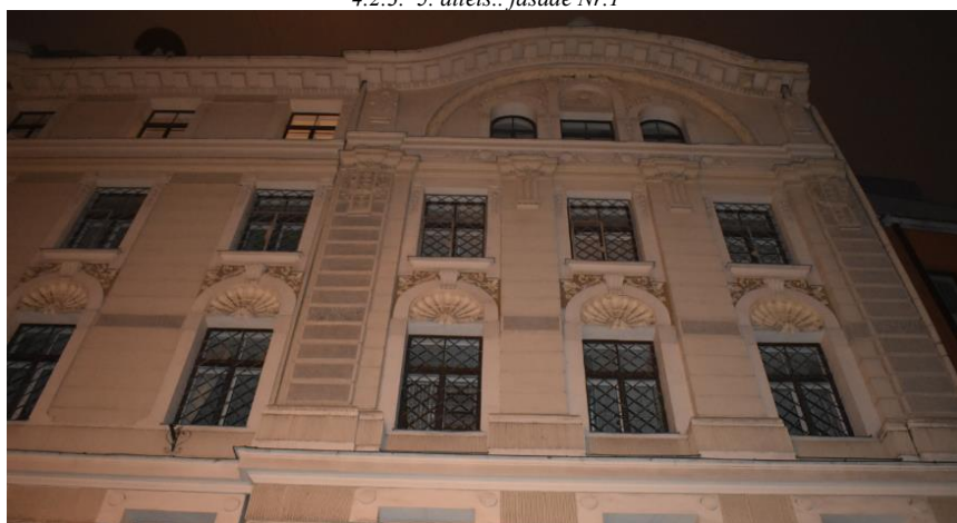
4.2.3. 6. attēls.. fasāde Nr.1 Apdare labā tehniskā stāvoklī, izņemot karnīzes daļu
