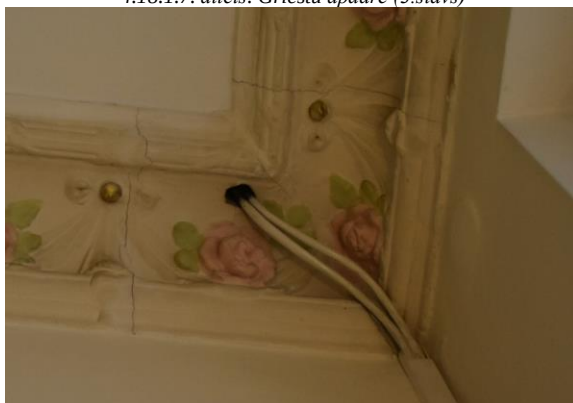
4.18.1.8. attēls. Nenoblīvēts inženiertīklu šķērsojums. Plaisas griestu dekoratīvajās līstēs (šādas plaisas raksturīgas visā ēkā.)
