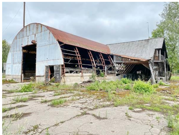
Zāgmateriālu pārstrādes cehs 001
