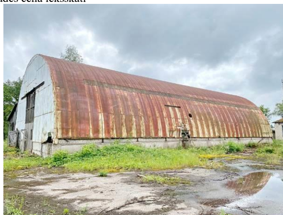
Zāgmateriālu pārstrādes cehs 001
