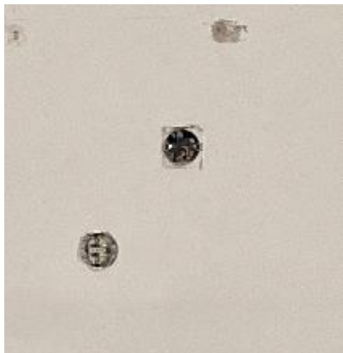
26. att. Elektroinstalācijas defekti
