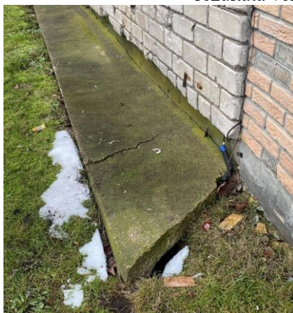
7. att. Bojāta nokrišņu novadapmale ēkas Z stūrī. Zem apmales redzami izskalojumi
