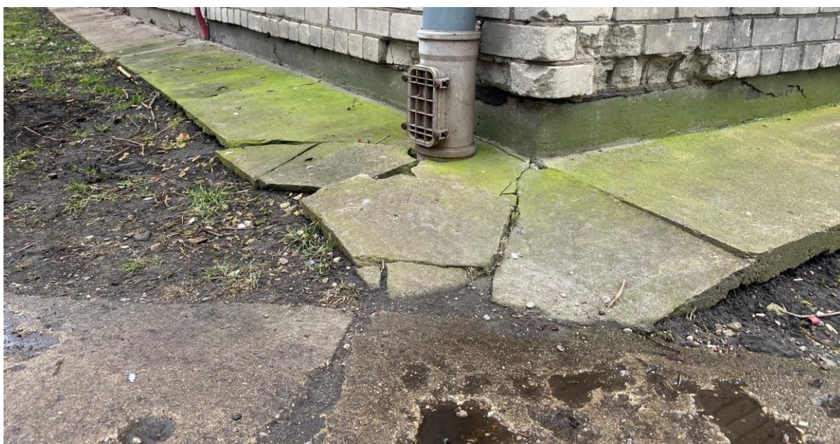
3. att. Ēkas A puses stūrī bojāta, deformējusies nokrišņu novadapmale
