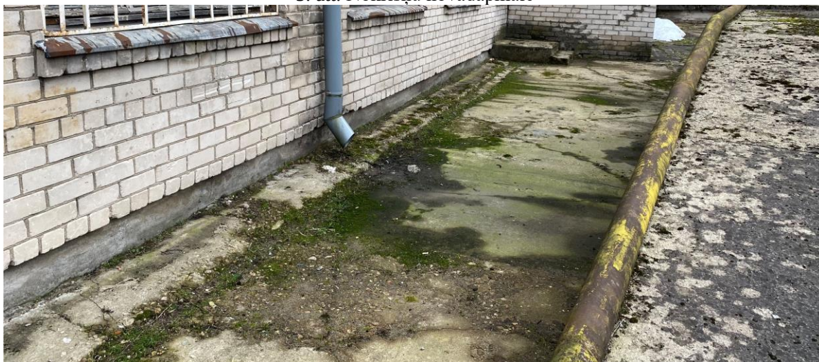
6. att. Pagalma puses segums bojāts, deformējies, nenodrošina pilnvērtīgu nokrišņu aizvadīšanu, kā rezultātā veidojas bioloģiskais apaugums
