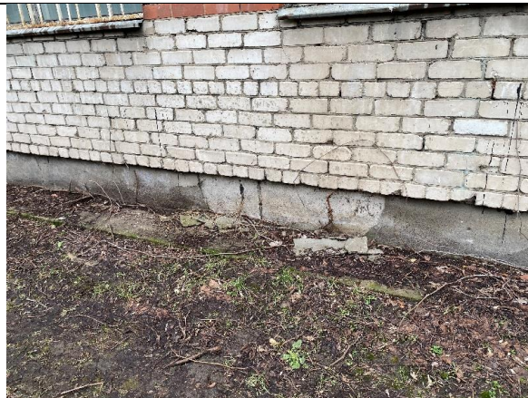
8. att. Ēkas D puses fasādē nokrišņu novadapmale vairākās vietās bojāta, deformējusies, pie cokola bijuši izauguši koki/krūmi. Dažviet bojāta cokola apdare
