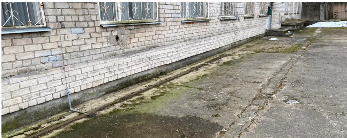
3. att. Uz ēkas cokola un pagalma puses seguma veidojas bioloģiskais apaugums, jo dažviet netiek nodrošināta efektīva nokrišņu aizvadīšana
