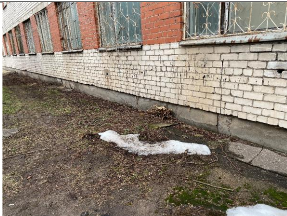
7. att. Ēkas D puses fasādē nokrišņu novadapmale vairākās vietās bojāta, deformējusies, pie cokola bijuši izauguši koki/krūmi. Dažviet bojāta cokola apdare
