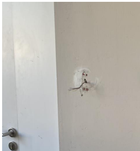
27. att. Elektroinstalācijas defekti
