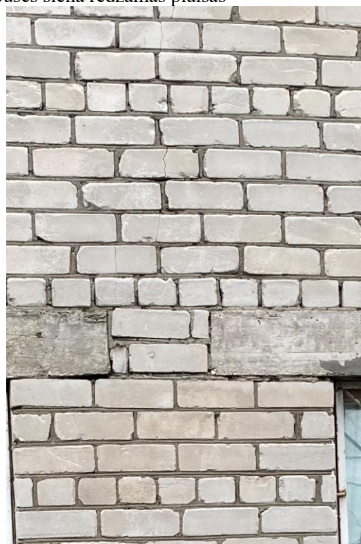
14. att. Ēkas ZR daļā ārsienās redzamas neliela atvērums plaisas
