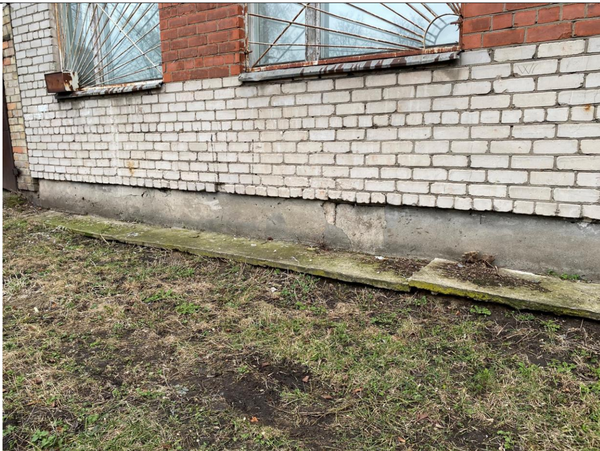
5. att. Ēkas D puses fasādē nokrišņu novadapmale vairākās vietās bojāta, deformējusies, pie cokola bijuši icauguši koki/krūmi. Dažviet bojāta cokola apdare
