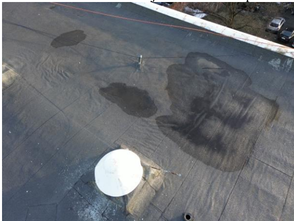
29. att. Jumta segumā lokālās zonās redzama iesēdumu, krokojumu veidošanās (2024. g. foto)
