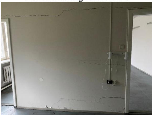
15. att. Ēkas ZR daļā – starp telpām Nr. 16 un Nr. 16 esošajā starpsienā redzamas plaisas
