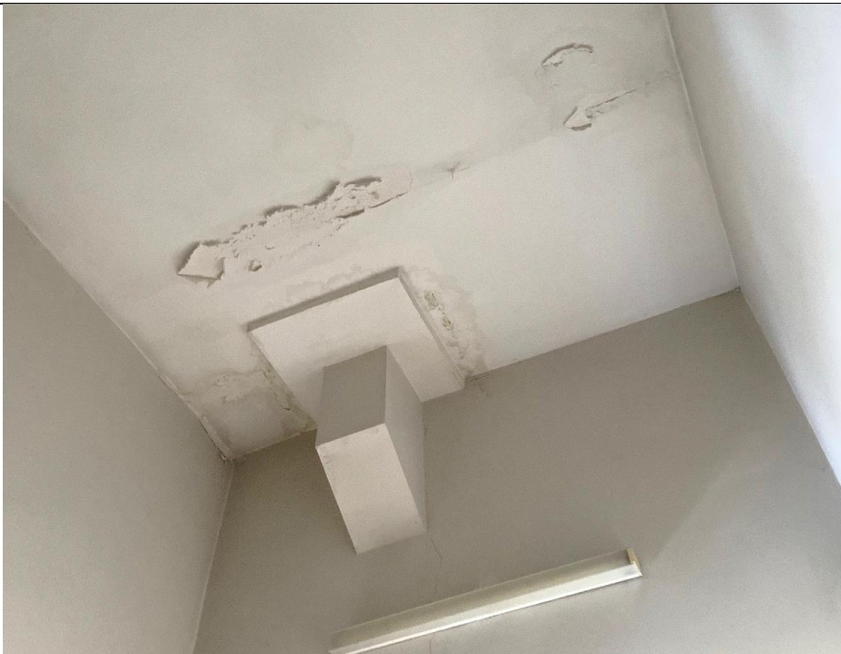
21. att. Jumta izbūves apjoma pārsegumā redzams mitruma piesātinājums, griestu apdares bojājumi zonā pie lietus ūdens notekas šķērsojuma
