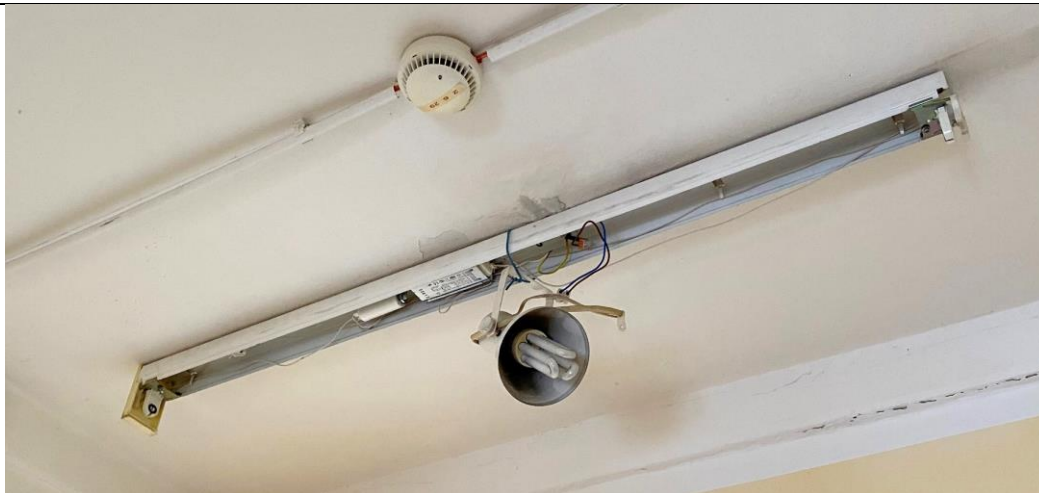
30. att. Elektroinstalācijas defekti
