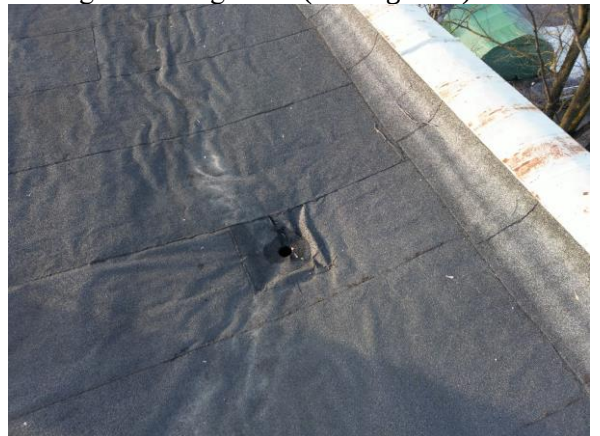
30. att. Jumta segumā lokālās zonās redzama iesēdumu, krokojumu veidošanās (2024. g. foto)
