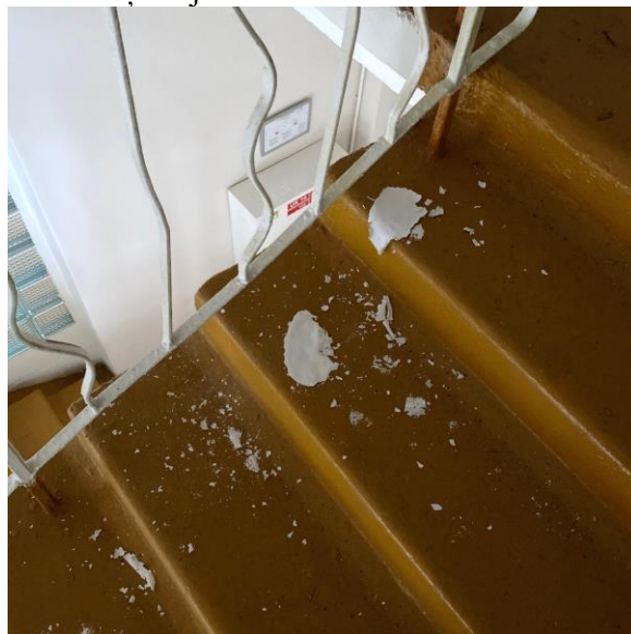
23. att. Griestu apdares fragmenti sakrituši uz kāpnēm
