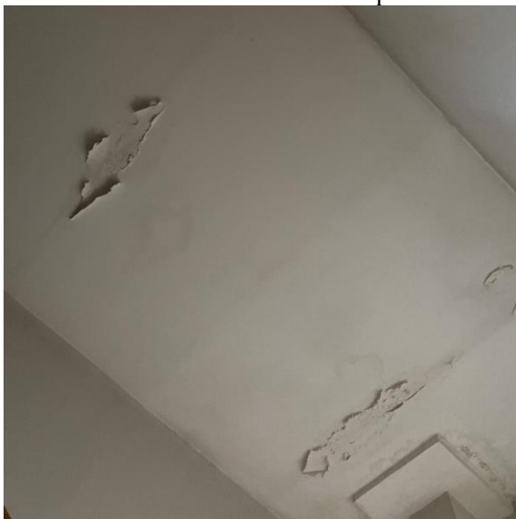
22. att. Jumta izbūves apjoma pārsegumā redzami mitruma bojājumi, apdares atslāņošanās
