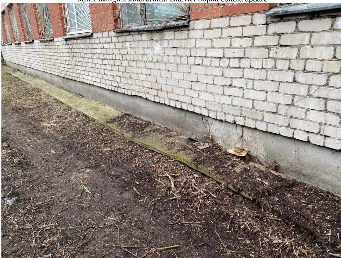
6. att. Ēkas D puses fasādē nokrišņu novadapmale vairākās vietās bojāta, deformējusies, pie cokola bijuši icauguši koki/krūmi. Dažviet bojāta cokola apdare
