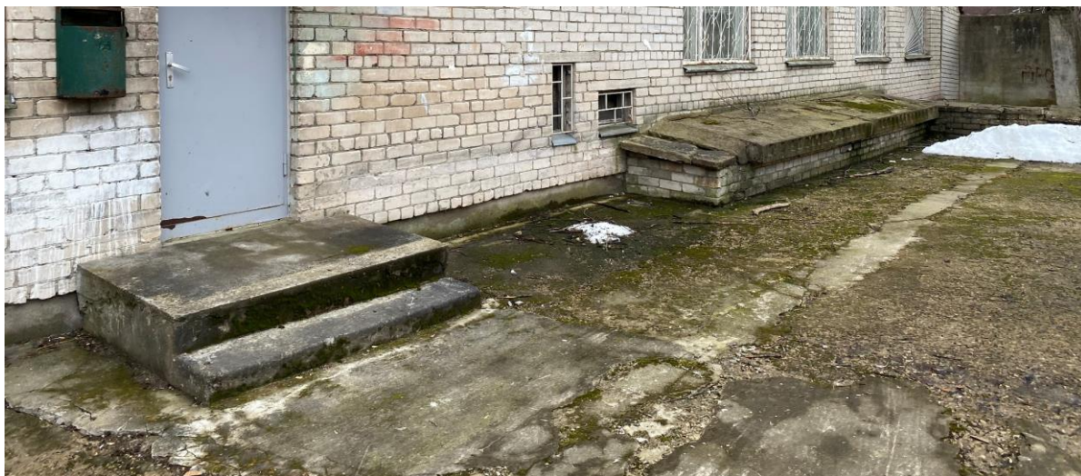
4. att. Uz ēkas cokola un pagalma puses seguma veidojas bioloģiskais apaugums, jo dažviet netiek nodrošināta efektīva nokrišņu aizvadīšana. Ēkas ZR stūrī cokolam piekļaujas siltumtrase
