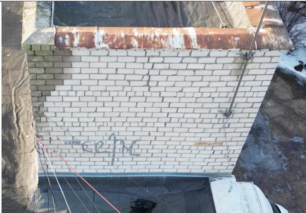
12. att. Jumta izbūves apjoms. A puses sienā redzamas plaisas
