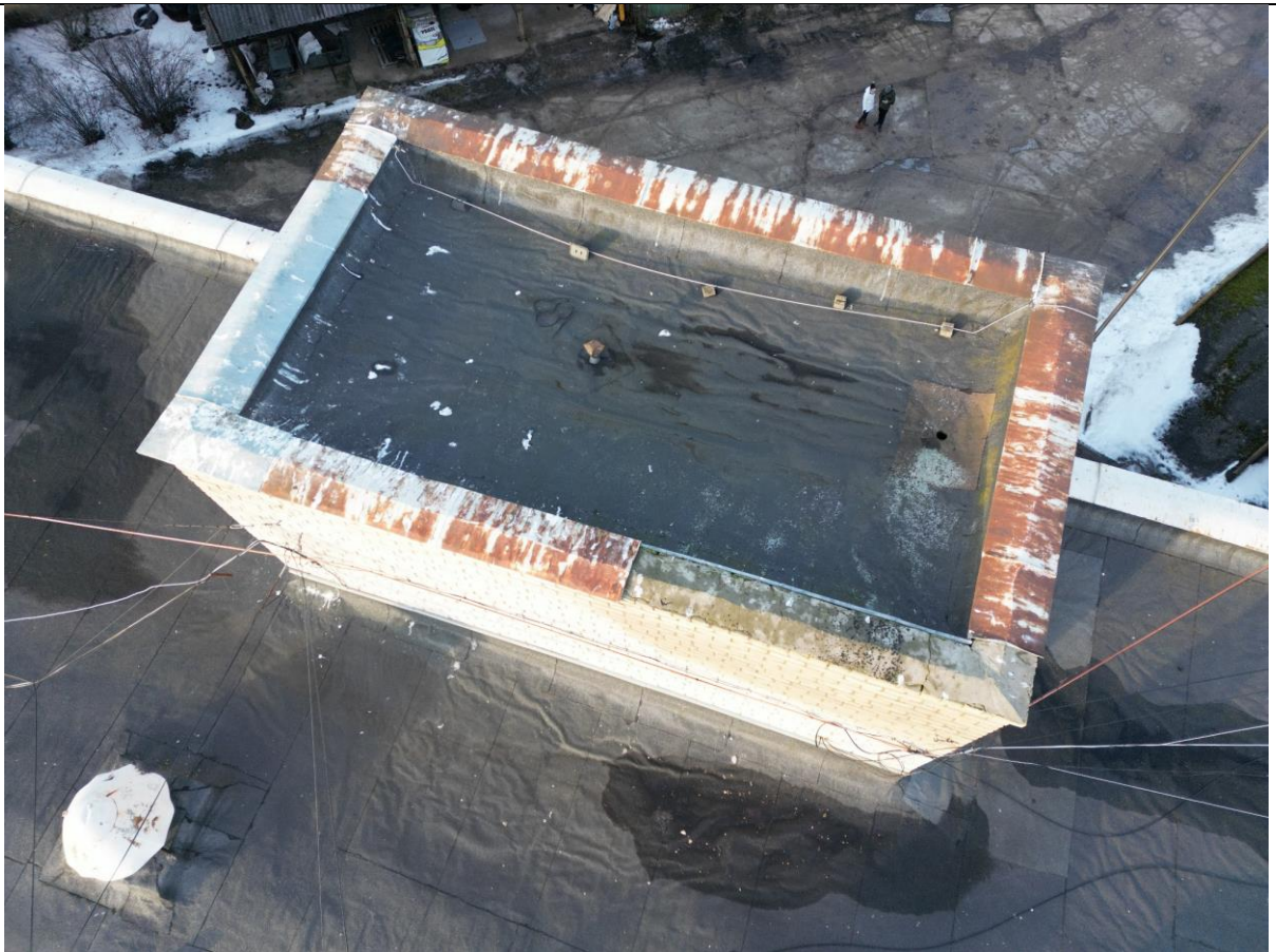
28. att. Jumta izejas izbūve. Parapetam zudis nosežskārda fragments (2024. g. foto)
