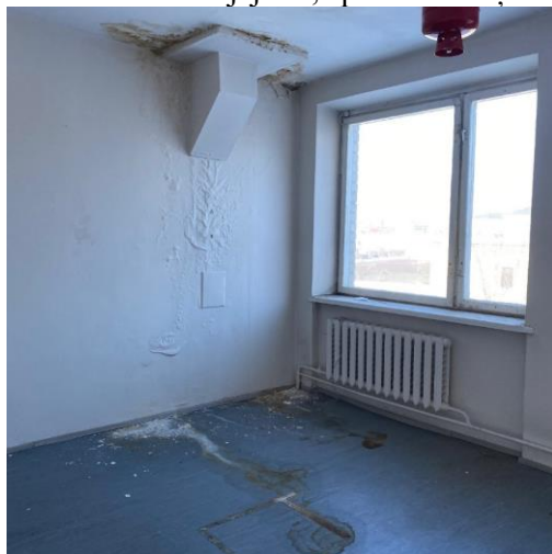
24. att. Ēkas 4. stāva telpā Nr. 1, zonā, kur izbūvēts lietus notekas šķērsojums pārsegumā, nokrišņu mitums nonāk ēkā, redzami bojājumi griestu un sienu apdarē
