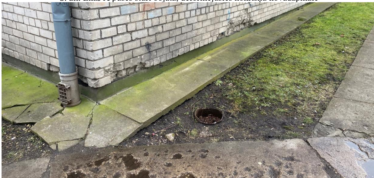
4. att. Ēkas A puses stūrī bojāta, deformējusies nokrišņu novadapmale. Cokolā lokālās zonās redzamas plaisas, apdares bojājumi, veidojas bioloģiskais (aļģu) apaugums
