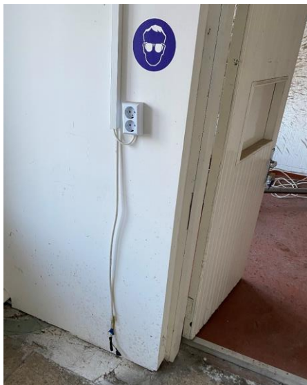
31. att. Elektroinstalācijas defekti
