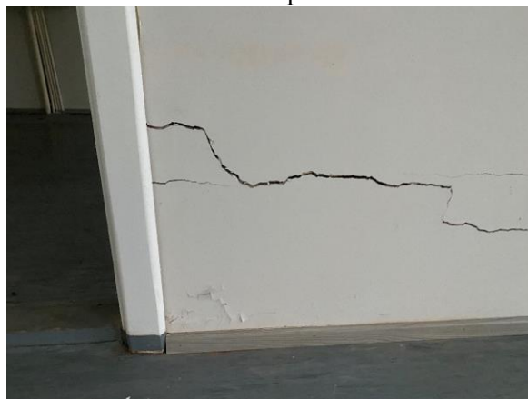
16. att. Ēkas ZR daļā – starp telpām Nr. 16 un Nr. 16 esošajā starpsienā redzamas plaisas
