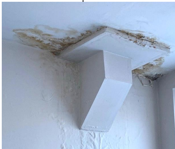
25. att. Ēkas 4. stāva telpā Nr. 1, zonā, kur izbūvēts lietus notekas šķērsojums pārsegumā, nokrišņu mitums nonāk ēkā, redzami bojājumi griestu un sienu apdarē
