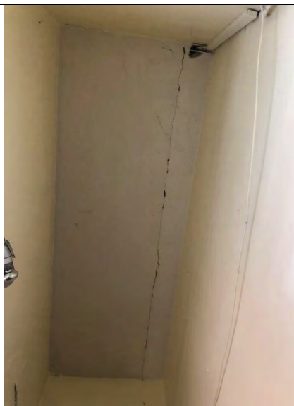
4.8.1.3. attēls. Jumta nesošā konstrukcija – plaisa plātņu sadurvietā
