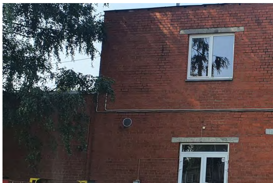
5.6.1.3.attēls. Ventilācijas reste uz fasādes no 1.stāva telpām
