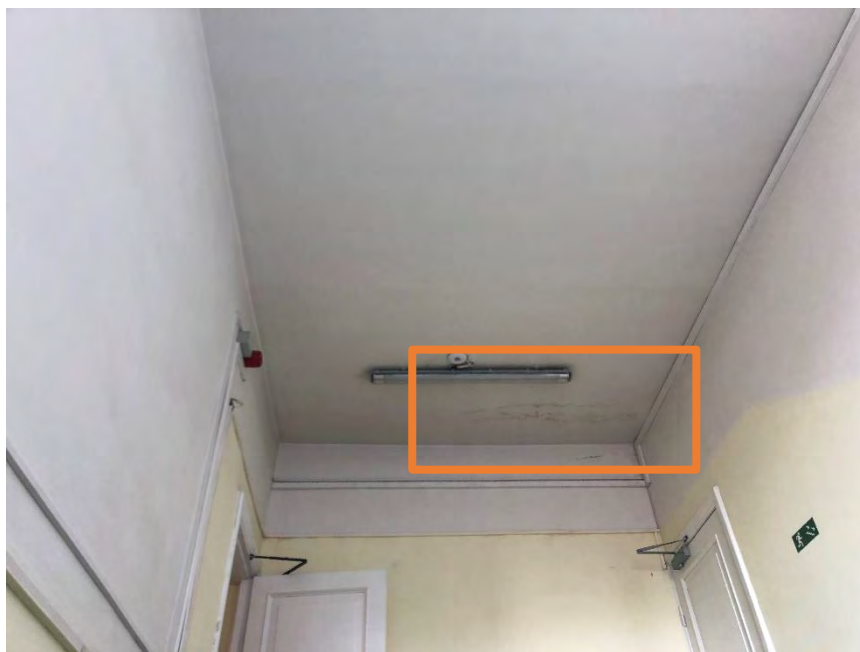
4.8.1.4. attēls. Jumta nesošā konstrukcija – mitruma piesātinājums
