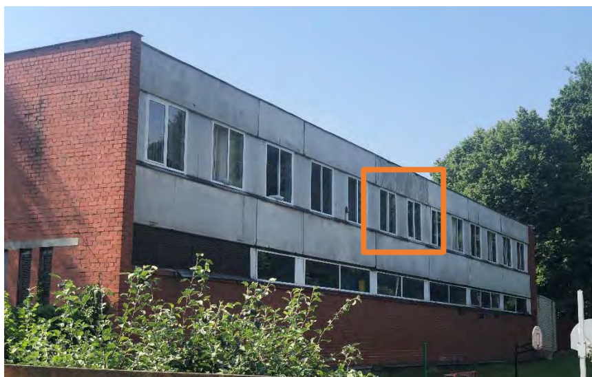
4.2.3.8. attēls. Bojāts panelis (ēkas Z fasāde)
