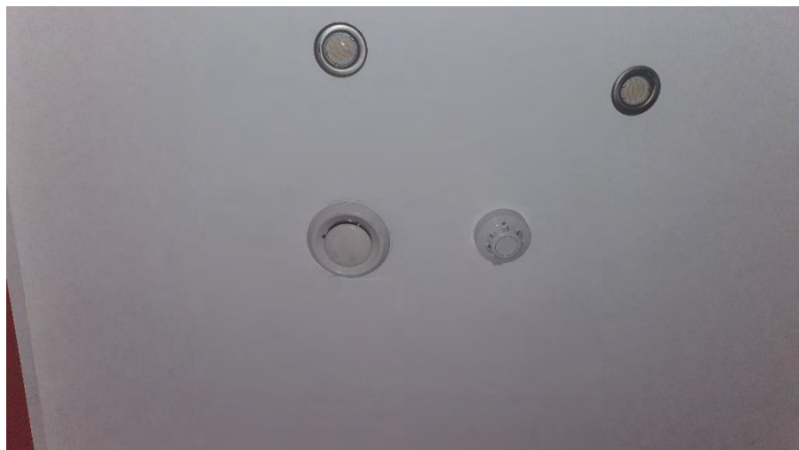
5.3.2.4. attēls Dūmu detektors
