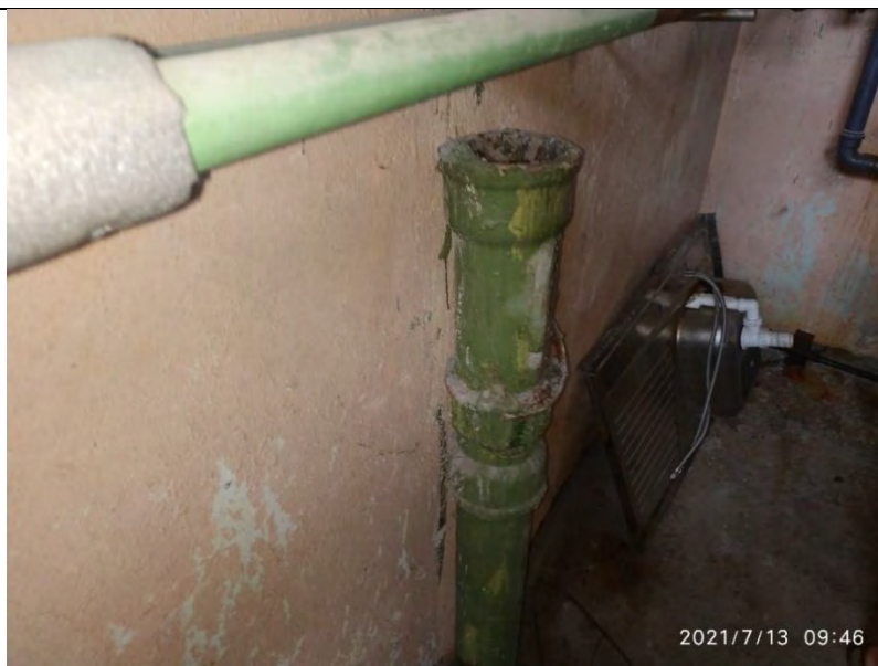
5.1.2.1. attēls. Ķeta kanalizācijas stāvvads, bojāts un neekspluatējams
