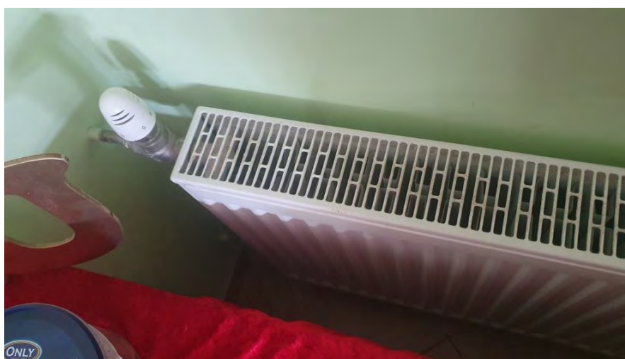
5.5.1.3.attēls. Tērauda radiators 1.stāvā ar nekorekti uzstādīto termostatu vertikāli
