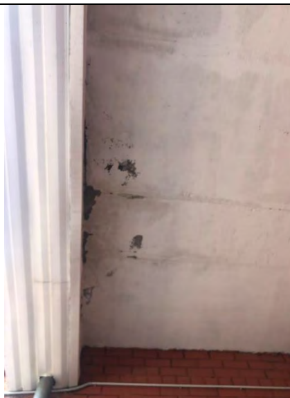
4.8.1.2. attēls. Jumta nesošā konstrukcija – mitruma piesātinājums
