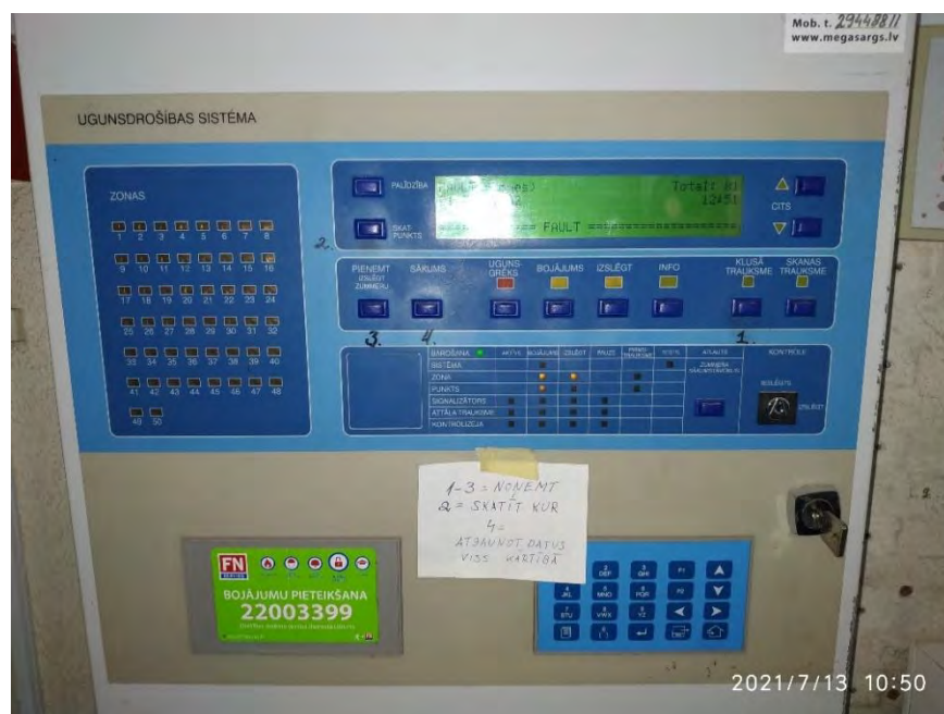
5.3.2.2. attēls Ugunsdrošības signalizācijas sistēmas panelis
