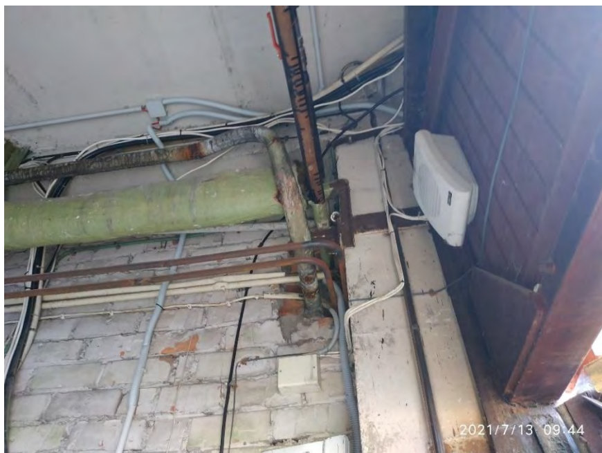
5.1.1.4. attēls. Cauruļvadi tehniskajā telpā
