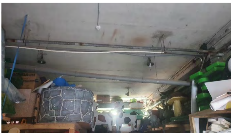
5.1.2.2. attēls. Kanalizācijas tīkls pie griestiem
