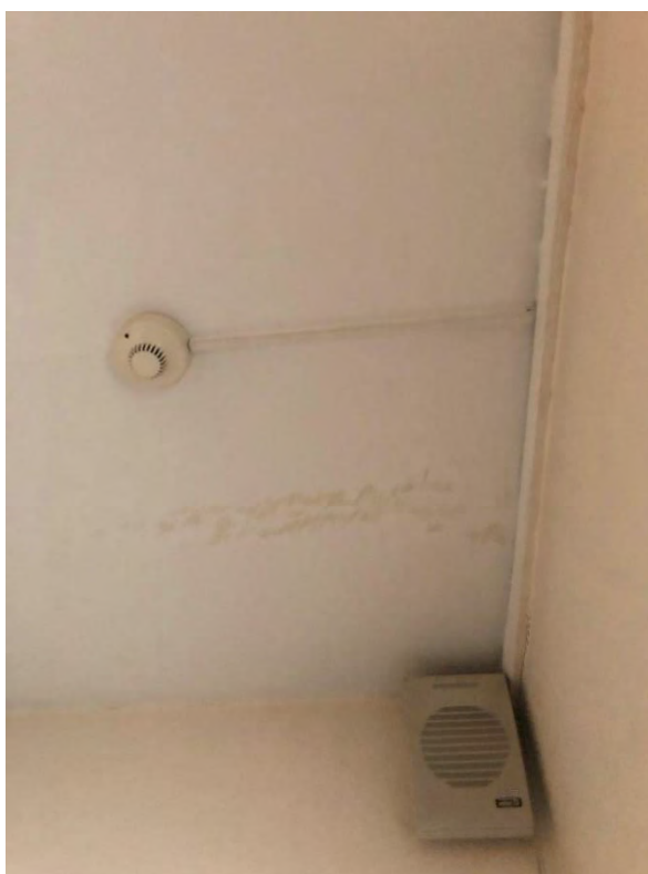
4.6.2.2. attēls. Bēniņu pārsegums – mitruma radīts plankums (3. stāvs, telpa Nr. 1, 017)
