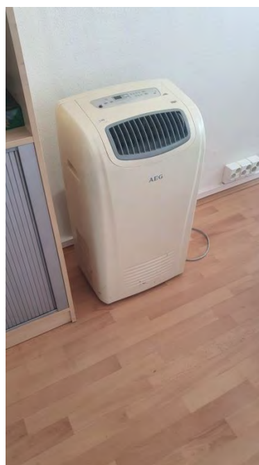
5.6.1.7.attēls. Mobilais kondicionieris kabinetā
