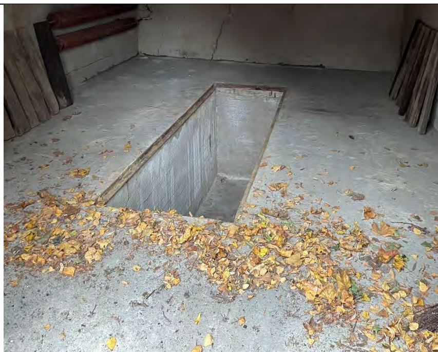
4.12.1.4. attēls. Betona klona grīda (telpa Nr. 1, 012)
