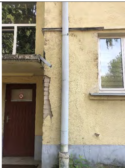
4.19.1.4. attēls. Saplaisājusī, atslāņojusies apdare (ēkas R fasāde)
