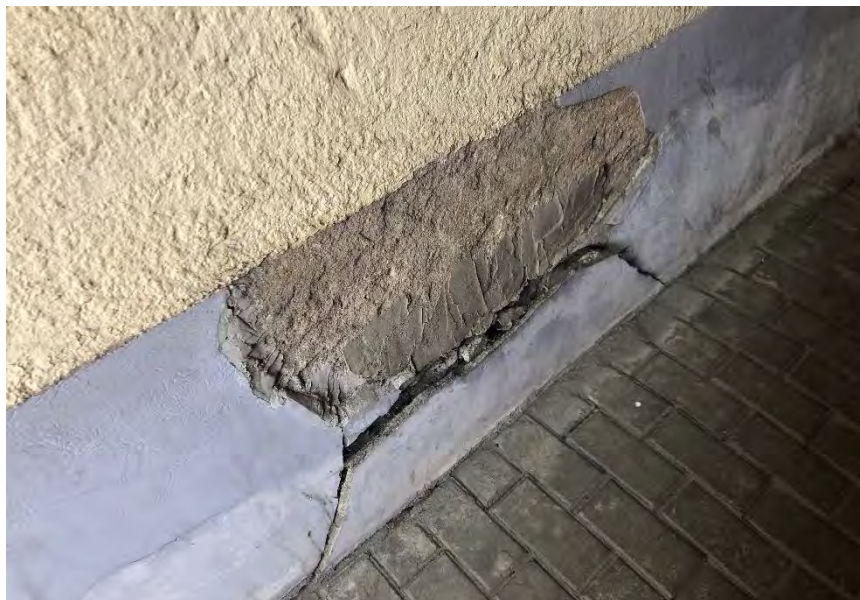
4.19.1.6. attēls. Atslāņojusies apdare, veikts lokāls labojums (ēkas D fasāde)
