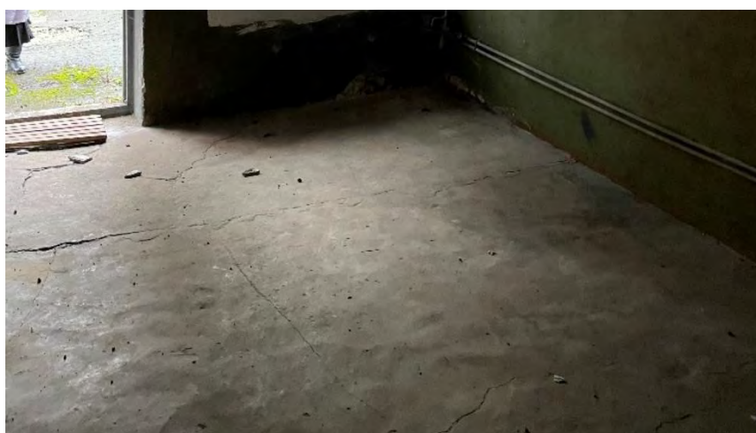
4.12.1.2. attēls. Betona klona grīda (telpa Nr. 1, 015)
