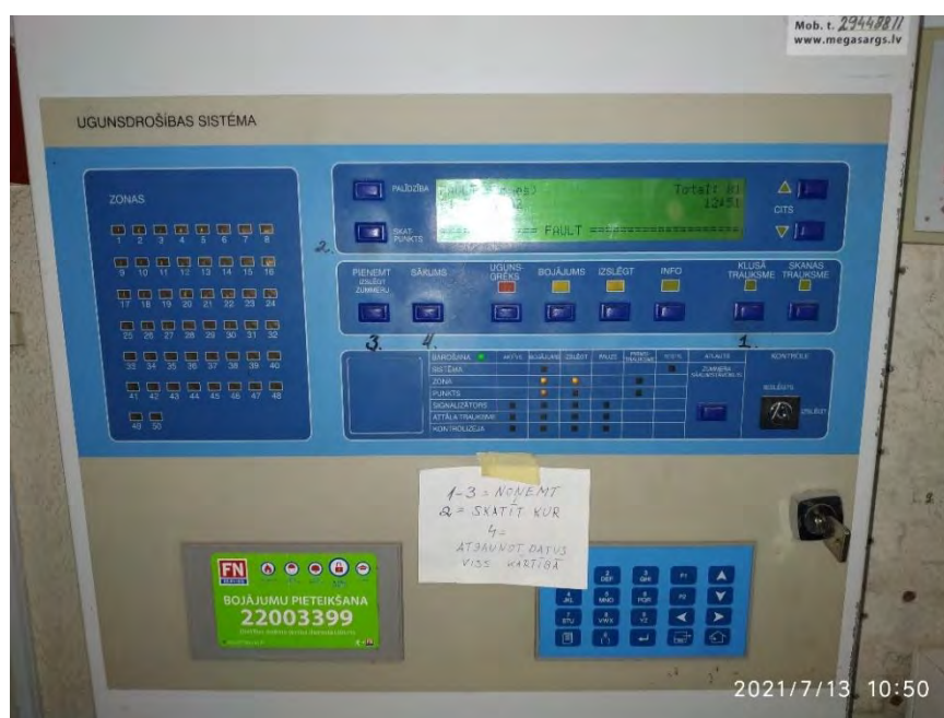
5.3.2.2. attēls Ugunsdrošības signalizācijas sistēmas panelis
