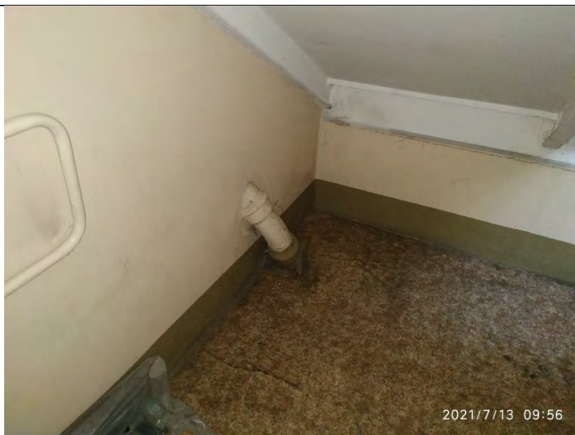
5.1.2.3. attēls. Kanalizācijas tīkla fragments zem kāpnēm
