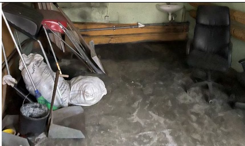
4.12.1.1. attēls. Betona klona grīda (telpa Nr. 1, 001)
