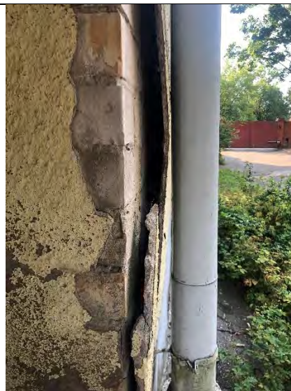
4.19.1.5. attēls. Atslāņojusies apdare (ēkas R fasāde)
