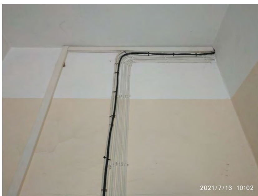
5.9.1.5. attēls. Kabeļi montēti virsapmetuma, bez caurulēm vai penāļiem
