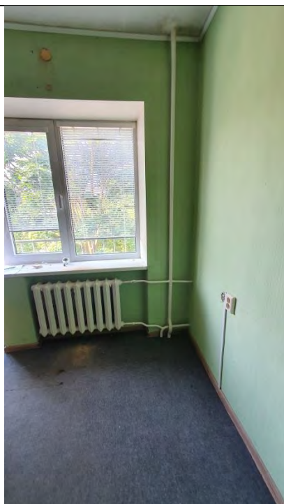
5.5.1.1.attēls. Čuguna radiators kabinetā
