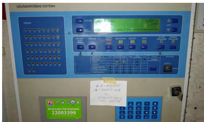
5.3.2.2. attēls Ugunsdrošības signalizācijas sistēmas panelis
