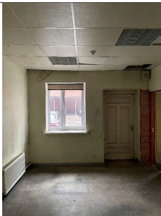
5.9.1.3.attēls. Novecojuši gaismekļi
