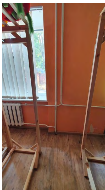
5.5.1.2.attēls. Čuguna radiators kabinetā
