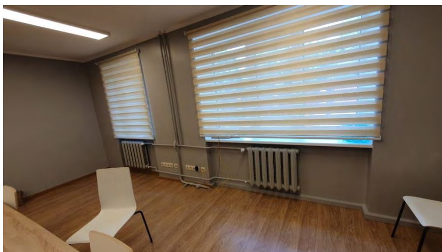
5.5.1.3.attēls. Čuguna radiatoriem ir uzstādīti termostati bet apvadlīnijas pārsedze nav paredzēta
