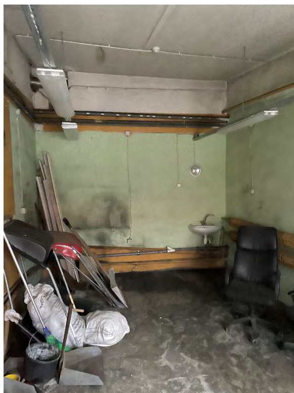
5.9.1.4.attēls. Novecojuši gaismekļi
