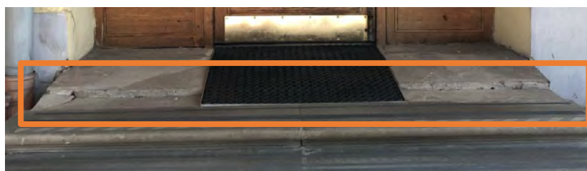
4.10.1.3. attēls. Kāpnes Nr. 1 - bojājums
