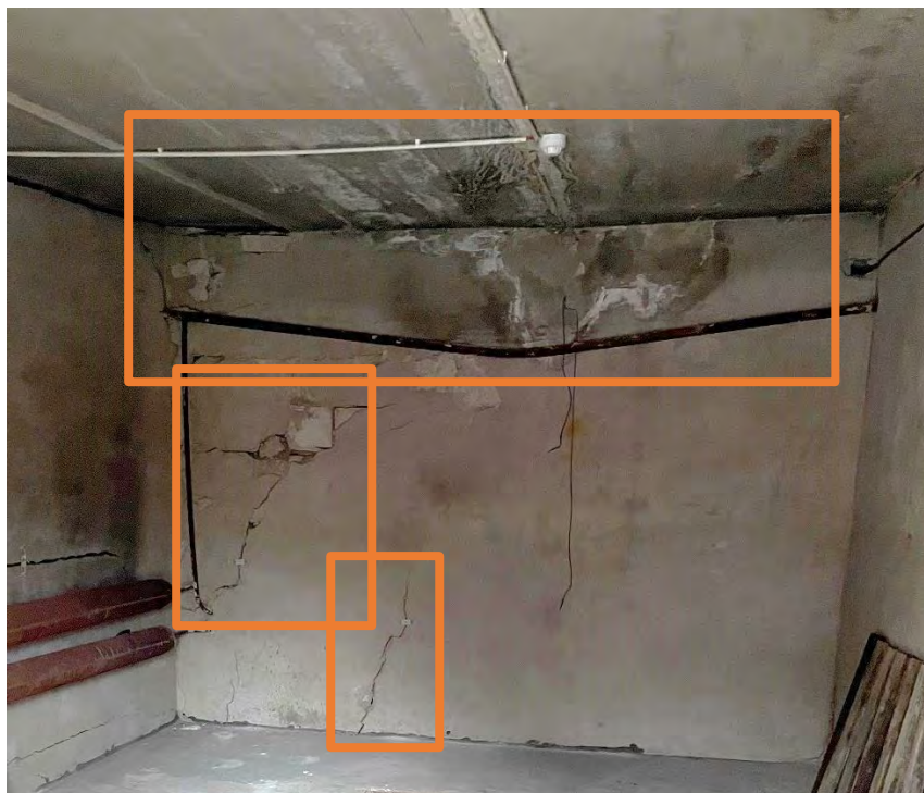
4.2.4.1. attēls. Plaisas ēkas iekšējā nesošajā sienā, mitruma piesātinājums
