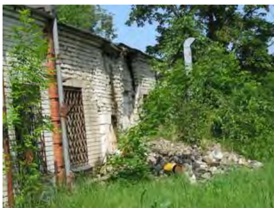
1.2.2-1 Ārsienu ķieģeļu mūra erozija, ap ēkas teritoriju uzkrājušies būvgruži.
