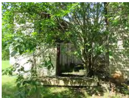
1.2.1-2 Demontēta un nav noslēgta daļa no ēkas.
