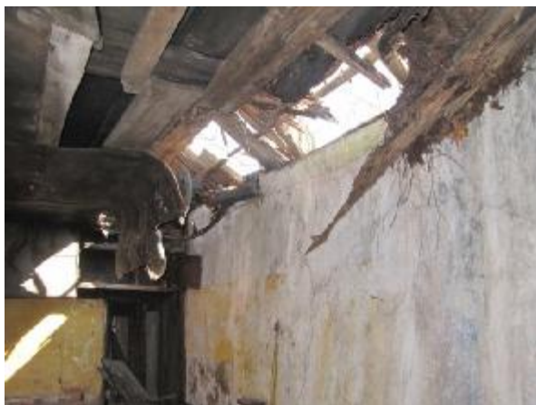
Telpas mājas iekšpusē – iebrucis pārsegums un jumta konstrukcijas
