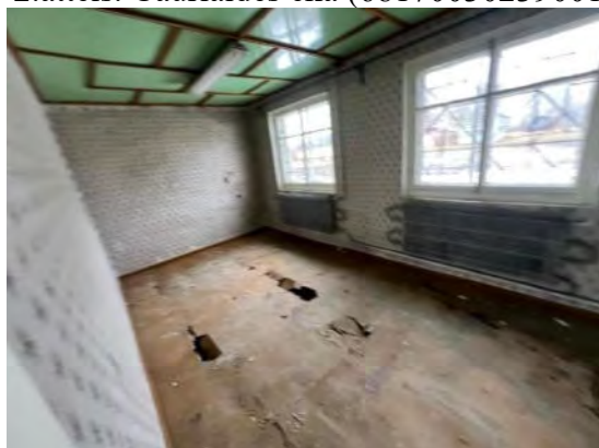
4.attēls. Caurlaides ēkas iekštelpas (grīdas bojājumi telpā Nr.5)
